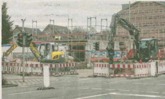
An der Sterkrader Straßen bauen die Gesundheitsdienste Reckmann aktuell ein neues Heim als Ersatz für das Christophorus-Haus gegenüber. FOTO: THOMAS GÖDDE
